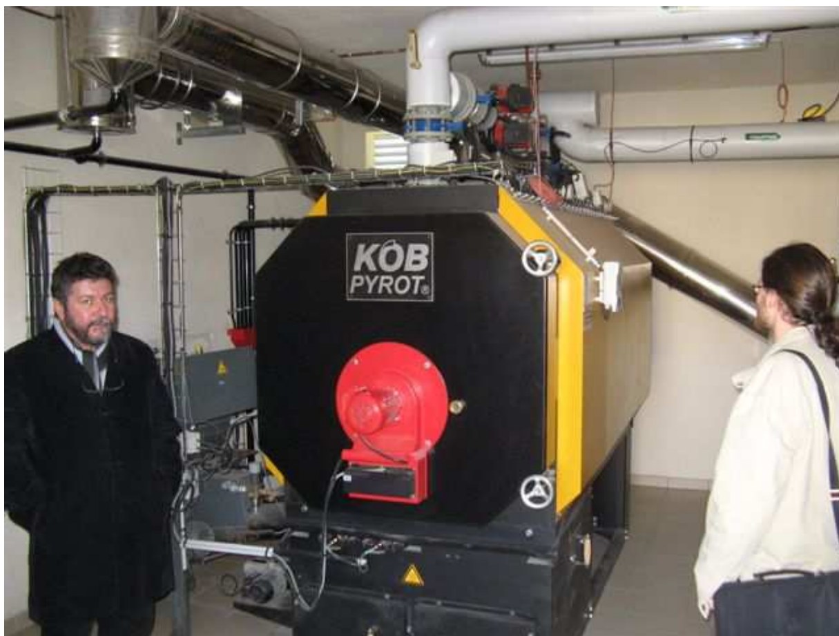
Exemple de réalisation d'une chaufferie Bois à VILLAMBLARD (Dordogne). Une délégation du Conseil Municipal de St Pierre et du SIPHEM a été accueillie par la Municipalité de ce village pour une visite des installations.
